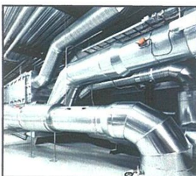
Aéraulique pour ventilation
