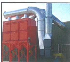
Aéraulique pour extraction centralisée
